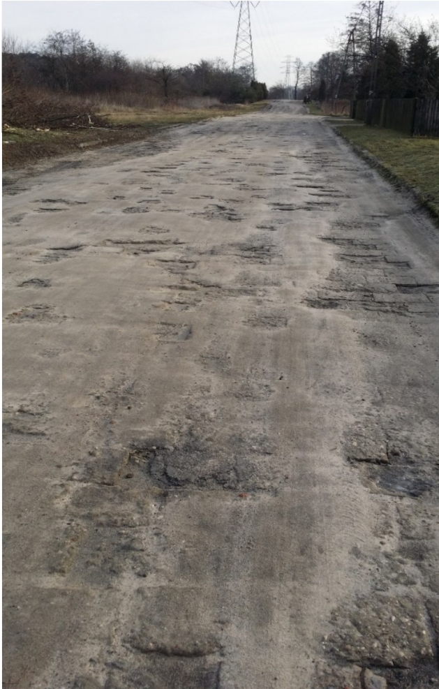
3. Ul. Zwycięstwa, zdegradowana i zanieczyszczona nawierzchnia jezdni z bloczków betonowych.
